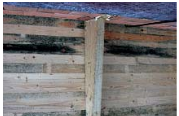
Missfärgande svampangrepp på trä – ett ständigt aktuellt problem
