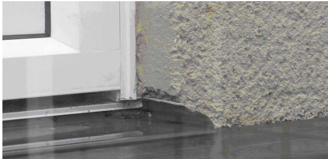
Dåligt utförd anslutning.
