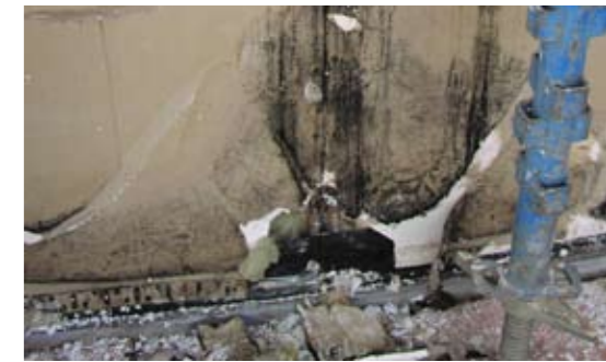
Fasaden dölde fuktskada.
