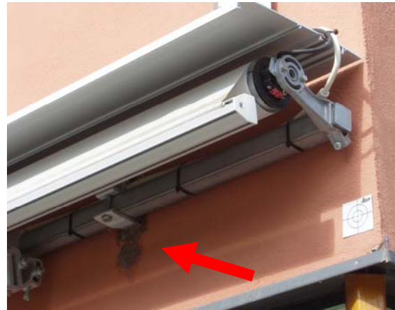
Bild 11. Markisinfästning med risk för läckage
