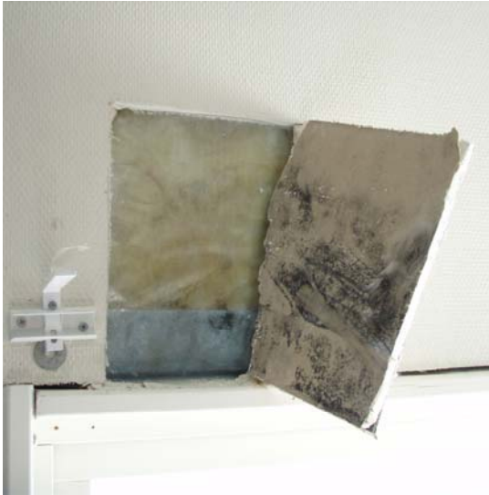
Bild 1. Mikrobiell påväxt på den invändiga gipsskivan orsakad av fukt som har läckt in.
