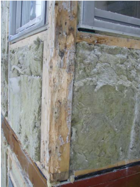
Fuktskadad regel som måste bytas
