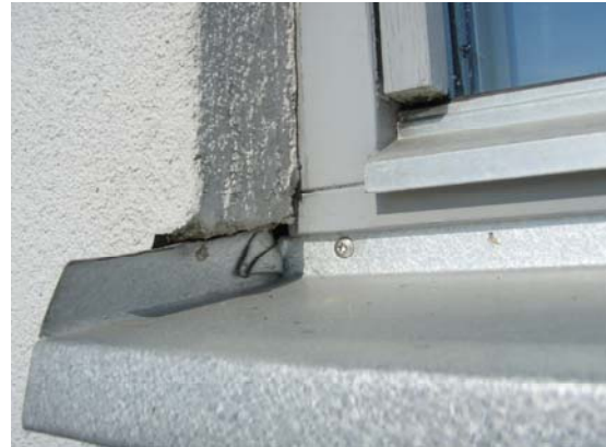
Bild 8. Otät anslutning vid fönsterbleck
