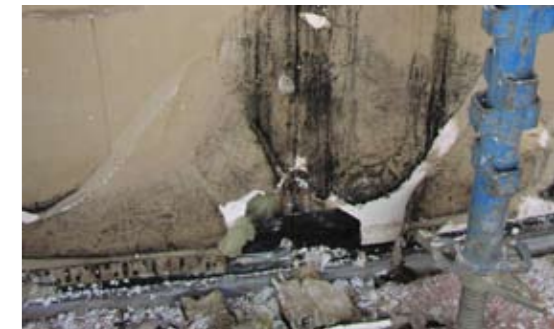
Fasaden dölde fuktskada.
