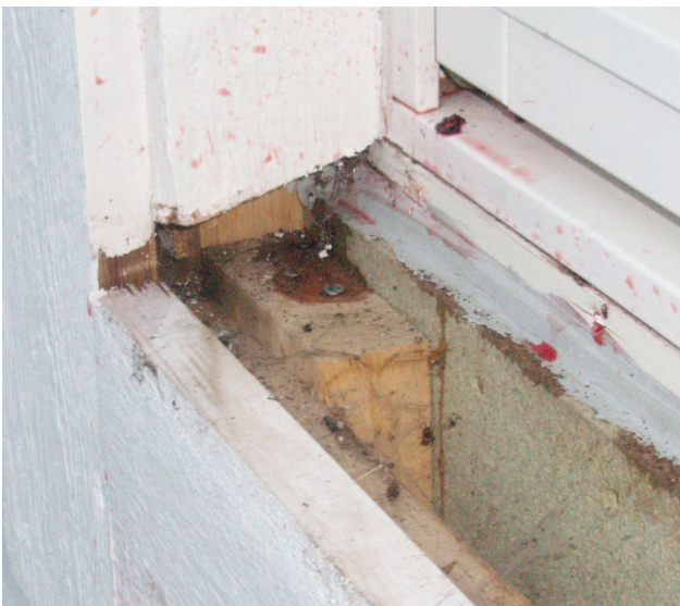
Exempel på läckage bakom fönsterbleck.
