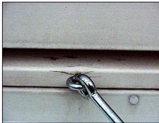
Sprickor i karmen vid infästning av stormhake.
